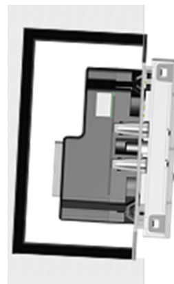
Unterputzdose falsch eingebaut
